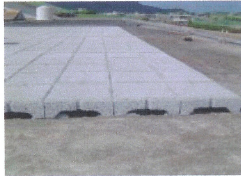
写真2. 遮蔽ブロック
